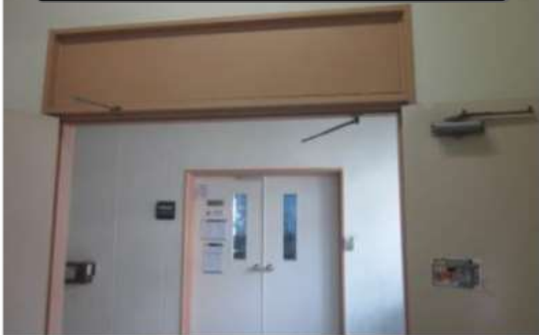
방화문 도어체크 탈락
