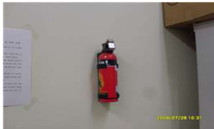
실험대 등에 간이소화기 설치(자연대)
